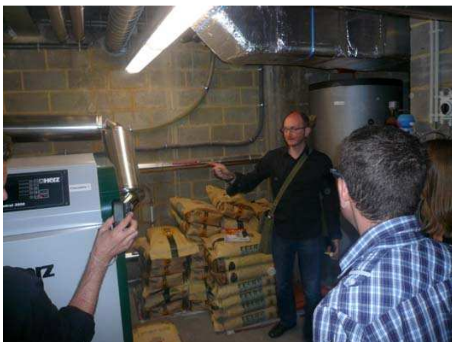
La chaufferie à granulés de bois centrale : 70 kw => chauffage par ventilation avec double flux et système de récupération de chaleur.
