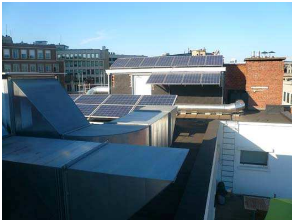
Sur le toit, produire de l'énergie solaire !
